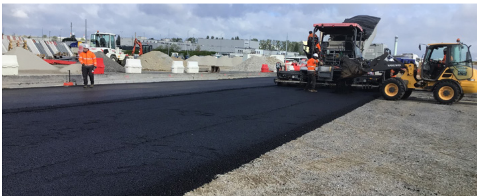
➤ Paris CDG, chaussée composite en BC6g/GB5 pour une aire de circulation avion. Mise en œuvre de la GB5.
