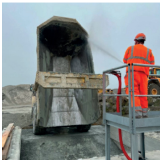
Nettoyage d'une benne
