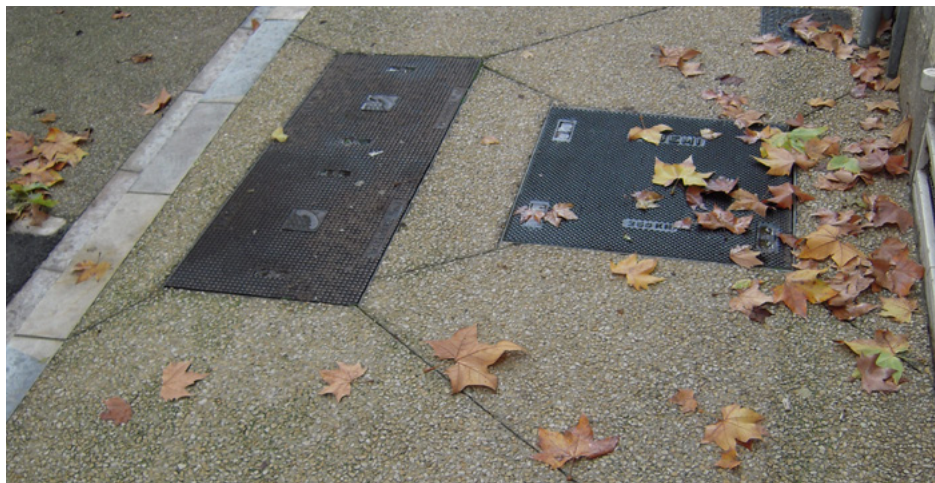
▲ Joint autour des émergences sur trottoir en béton désactivé
