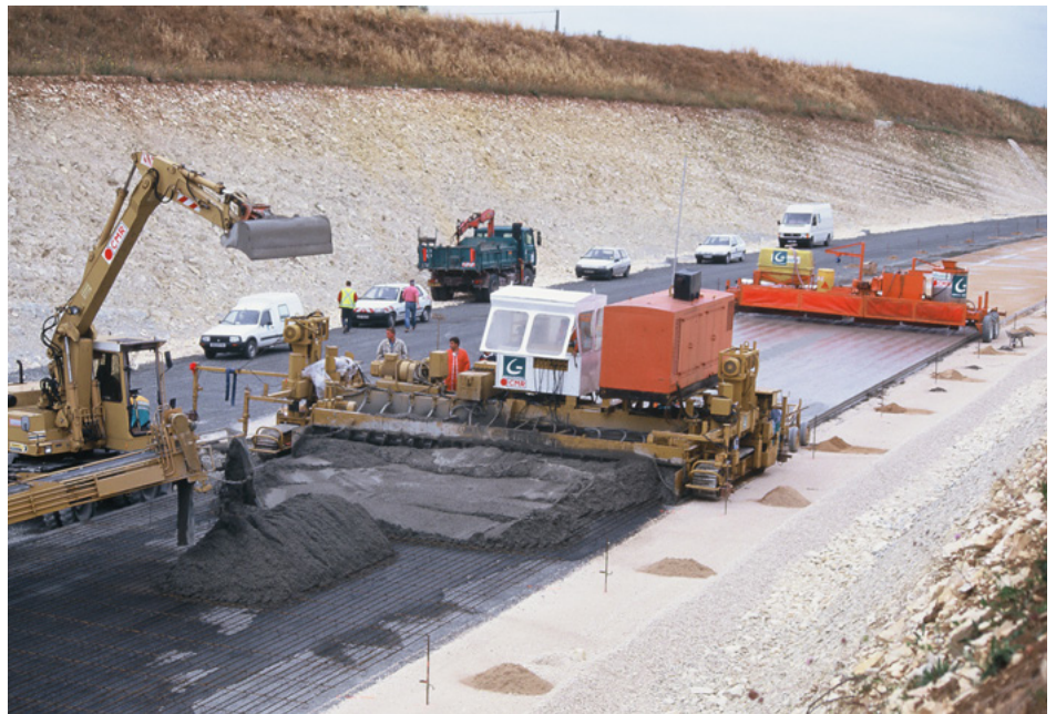
▲ Mise en œuvre à la machine à coffrages glissants d'une structure composite en Béton Armé Continu BAC sur Grave Bitume GB3. RN 141 ; Déviation des Rassats-Favrauds.
