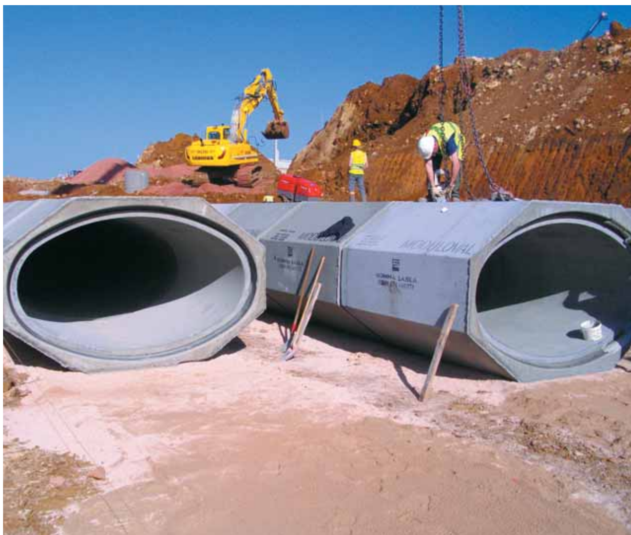
Les canalisations modulaires en béton préfabriqué (Bonna Sabla) permettent une mise en œuvre rapide pour collecter les eaux pluviales. Dans l'Orne, près d'Alençon, 470 éléments ont été emboîtés en seulement un mois et demi.
