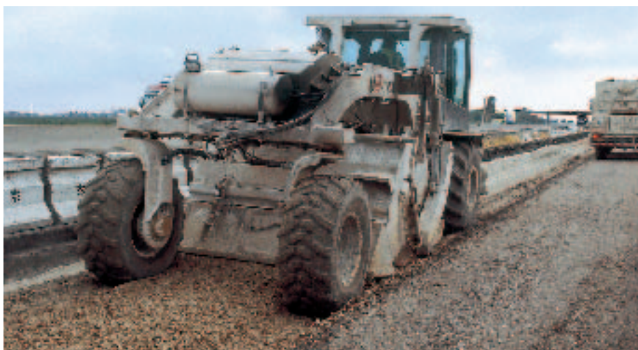
Le malaxeur mélange intimement les matériaux en place au liant hydraulique routier (et à la chaux, si nécessaire) pour réaliser la couche de forme de la nouvelle voie lente.
