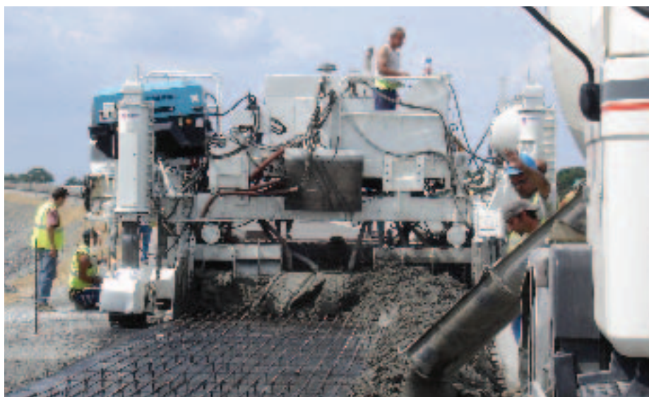
Une fois les aciers continus mis en place, le béton est déversé à l'avancement.
