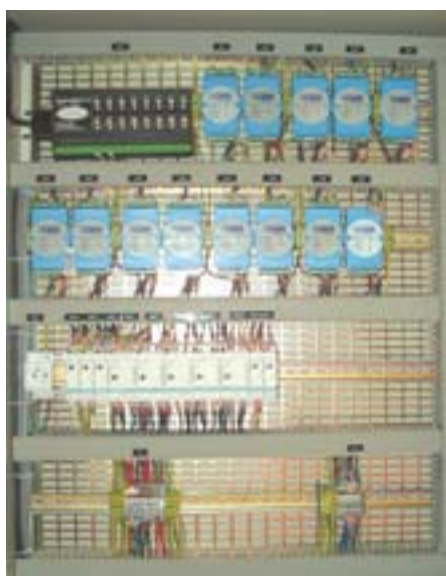
Centralisation des connecteurs du système d'acquisition.
