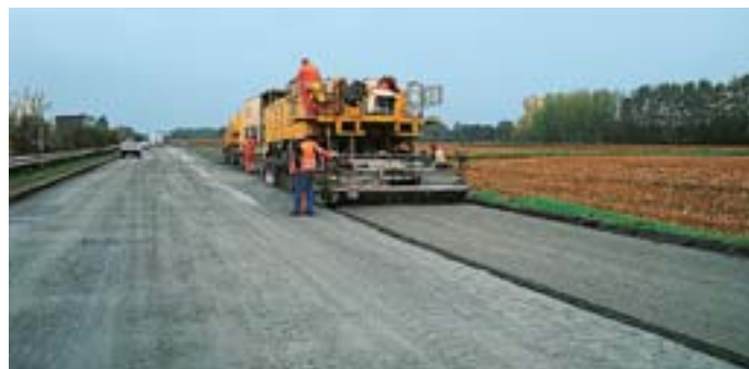
La technique du retraitement en place peut aussi être utilisée pour créer un élargissement de la chaussée à retraiter.
