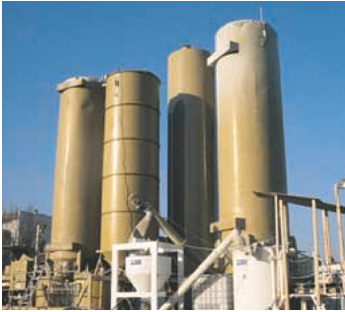
Centrale de fabrication du coulis bentonite-ciment.
