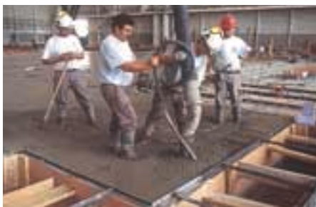
Le béton est d'abord réparti à la pompe puis vibré à l'aiguille.
