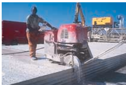
Les joints de retrait sont sciés dans un délai de 12 à 18 heures après le coulage du béton.
