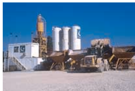
Une centrale mobile à production discontinue a été installée à proximité du chantier.
