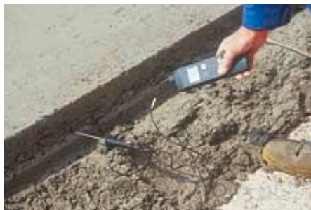
La mesure de température du béton permet de contrôler la montée en résistance.
