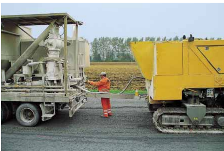
▲ Ajouté au matériau fraisé, le mélange liant hydraulique routier/eau permet d'obtenir in situ la nouvelle grave hydraulique.
