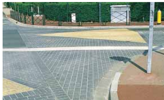
▲ Notre-Dame-de-Gravenchon : les deux couleurs du béton matricé mis en œuvre sur le carrefour de l'école signalent clairement à l'automobiliste l'entrée dans une zone très sensible, où circulent des enfants.
