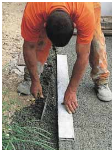
▲ Les bords de la dalle sont parfois repris pour corriger les épaufrures.
