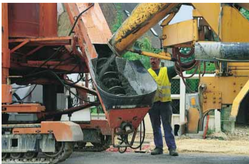
▲ Le béton prêt à l'emploi, fabriqué à la centrale de Rouen d'Unibéton, est acheminé par camion-toupie.
