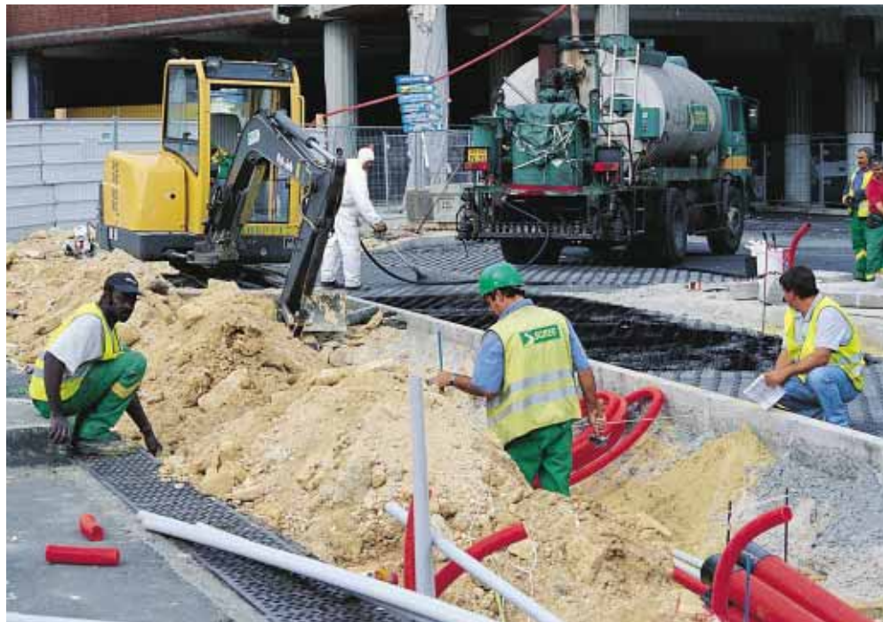
▲ Première étape : la préparation du support et l'intégration des différents réseaux enterrés.
