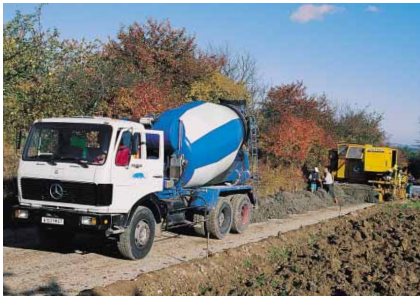
▲ Le béton a été pour l'essentiel livré par camion-benne, pour une grande rapidité de chargement et de déchargement.
