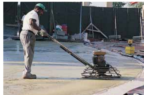
▲ La surface du béton a été tirée à la main et réglée à l'hélicoptère.
