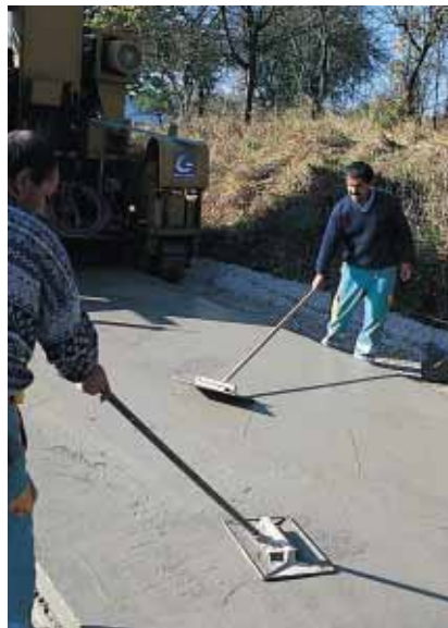
▲ Des retouches manuelles sont nécessaires pour parfaire la régularité de l'uni du béton.
