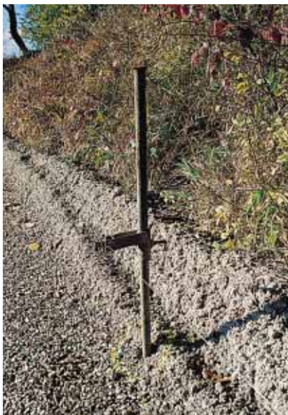
▲ Après correction granulométrique, apport de grave non traitée 0/20 et malaxage, sont implantés les piquets de guidage de la machine à coffrage glissant.
