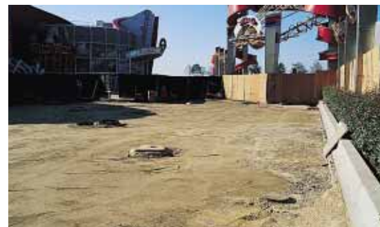
▲ L'ancienne chaussée, revêtue d'asphalté, a été décaissée sur une profondeur de 35 cm. La plate-forme a été reprofilée par la mise en place de 20 cm de grave.
