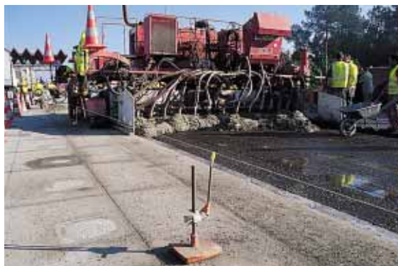
▲ Guidée par fil et palpeurs, la slip form met en place et vibre le béton sur une largeur de 5 m.
