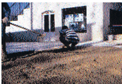
▲ Dernière opération, le talochage ferme le béton et le prépare à recevoir le produit désactivant.
