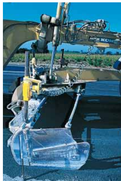
▲ La niveleuse est équipée d'un système de guidage par ultrasons qui fournit à partir d'un câble tendu une référence de hauteur avec une précision inférieure à 5 mm.
