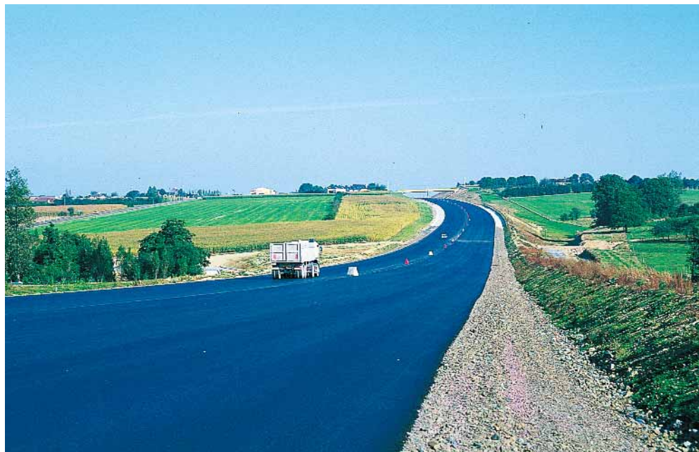
▲ À chantier d'exception, moyens d'exception. La réalisation de ce tronçon de l'A84 dans le Calvados fait appel à des techniques pointues et peu coûteuses, mises en œuvre dans des délais records.
