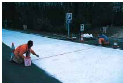
▲ La variation de la trame de sciage des joints de retrait a rendu délicates les opérations de marquage.
