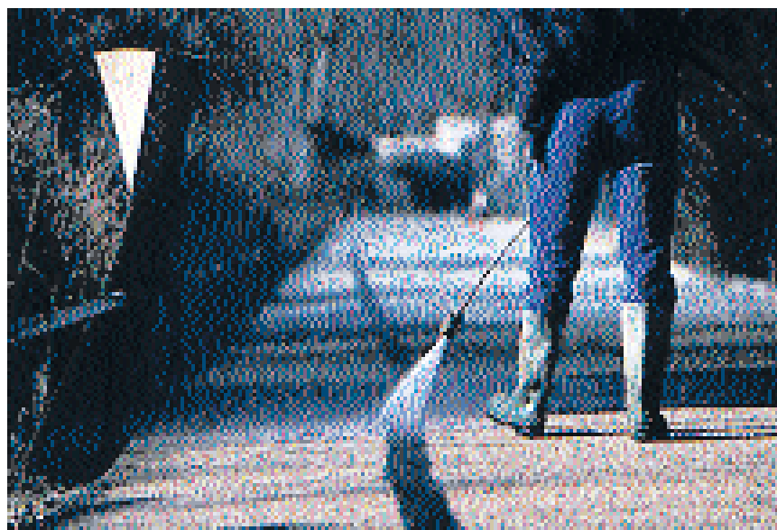
▲ Pour protéger la flore du parc, le lavage du béton désactivé s'opère avec des protections.
