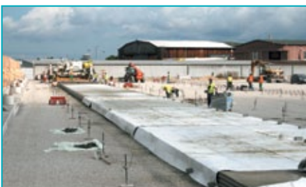
Mise en place des bâches de protection thermique sur la couche de fondation et sur la couche de roulement.
