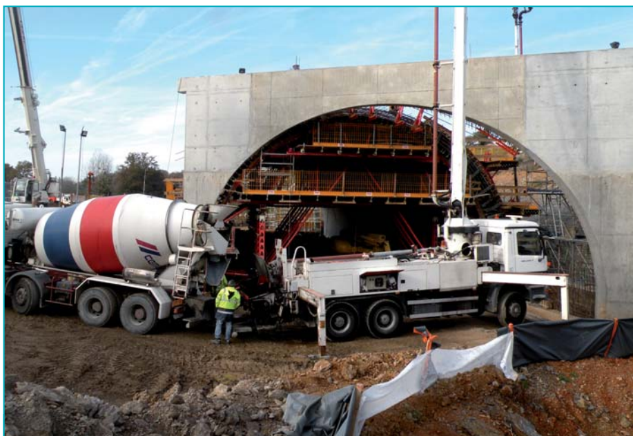
Pièce essentielle du projet, chaque tympan d'about, chargé de reprendre les efforts engendrés par la poussée des terres une fois l'ouvrage enterré, est réalisé avec soin.
