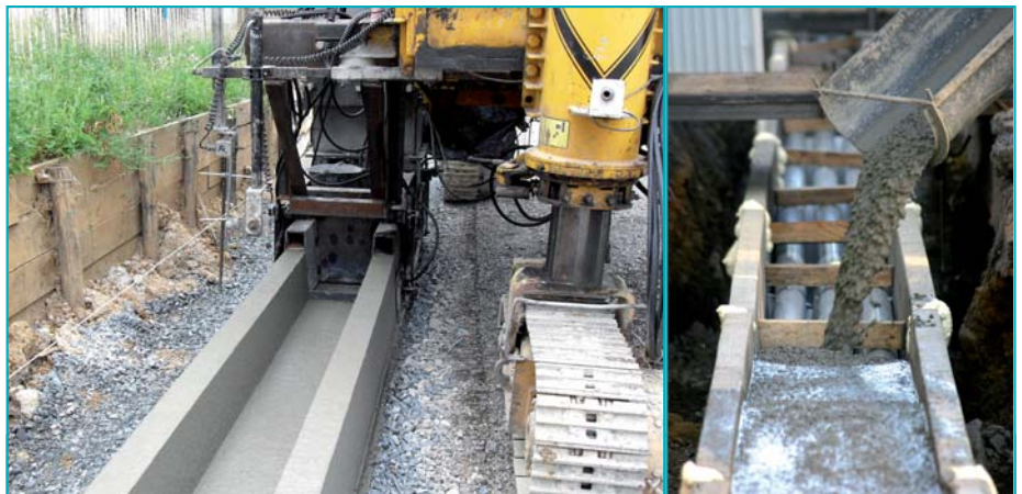
Une machine à coffrage glissant réalise le "U" en béton extrudé (à gauche), destiné à recevoir les multitubulaires qui sont ensuite immobilisés par le coulage d'un béton autoplaçant (à droite).
