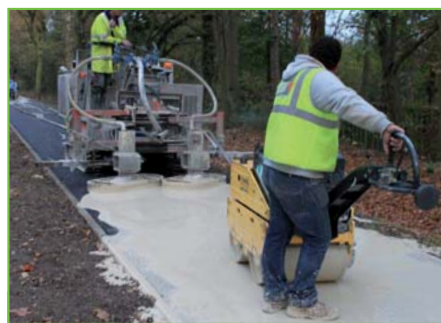
Rambouillet : une machine, permettant d'injecter le coulis de ciment en continu, a permis d'industrialiser le procédé.
