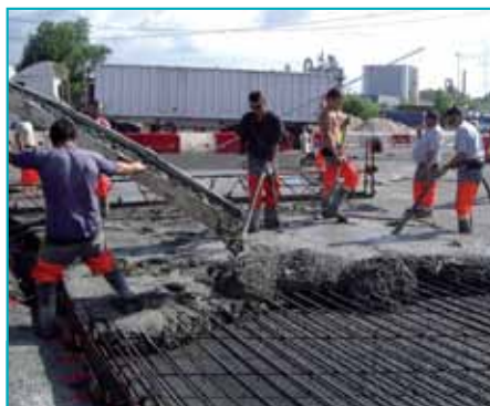
Le ferrailage est constitué d'armatures longitudinales haute adhérence de 16 mm de diamètre.
