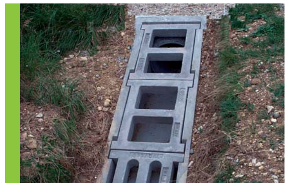
Tête d'aqueduc de sécurité
