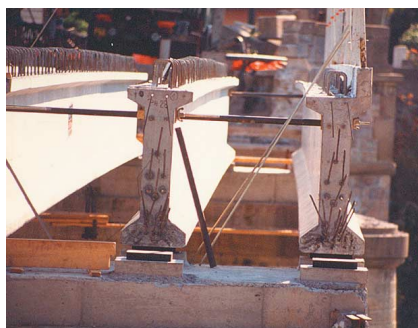
Dispositif de stabilisation des poutres.
