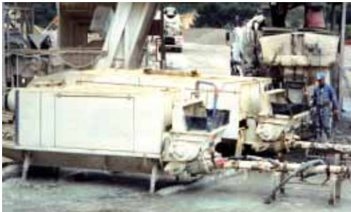
Pompe stationnaire utilisée en poste fixe.
