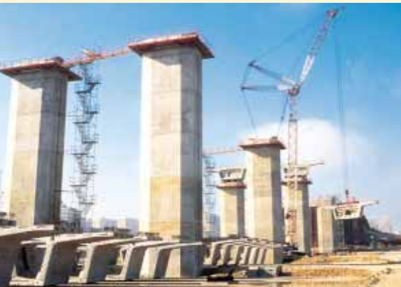
▲ Plusieurs méthodes de construction ont été mises en œuvre : les éléments du tablier du viaduc de l'Exposition ont été assemblés à la grue.
