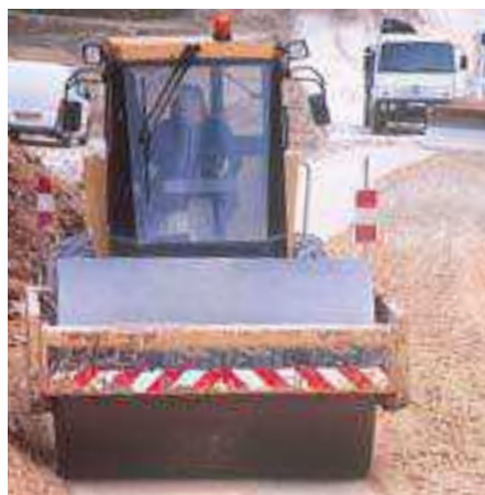
Le nombre de passes des compacteurs est déterminé in situ (avec des planches d'essais) afin d'obtenir la densité optimale.
