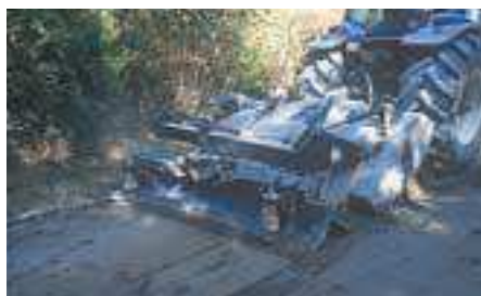
Le traitement de sol, réalisé par un concasseur, est suivi d'un compactage.
