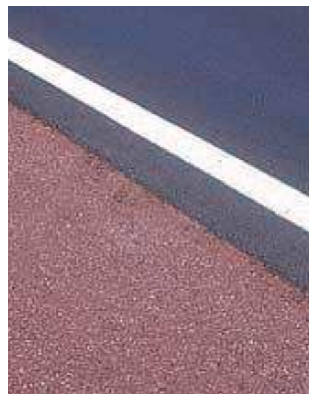
Le retraitement d'une chaussée gagne à être étendu aux accotements pour les stabiliser et accroître la sécurité des usagers.
