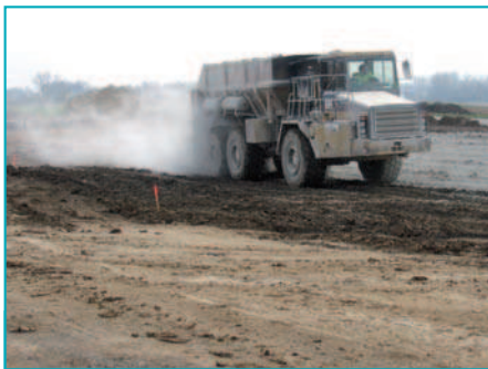
Après le premier arrosage, l'épandage du liant hydraulique routier intervient à raison de 32 kg/m 2 .
