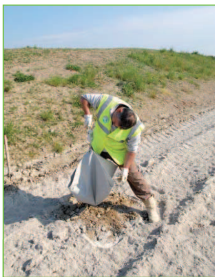
Un technicien vérifie par pesée le dosage exact en liant hydraulique routier (essai dit "à la bêche").
