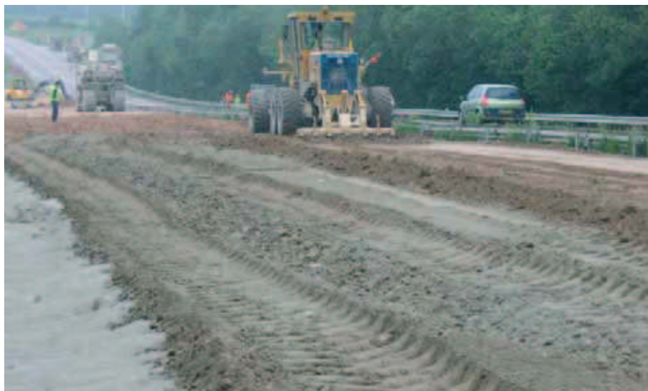
Scarification et préparation de la couche de forme, avant épandage du ciment et malaxage du sol à traiter.
