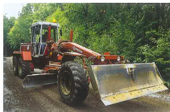
▲ Le passage d'une niveleuse à lame assure à la future chaussée un profil régulier. Il est suivi d'un second compactage, qui permettra après épandage d'un caillou de petite taille le bon accrochage de la couche de roulement en enrobé.
