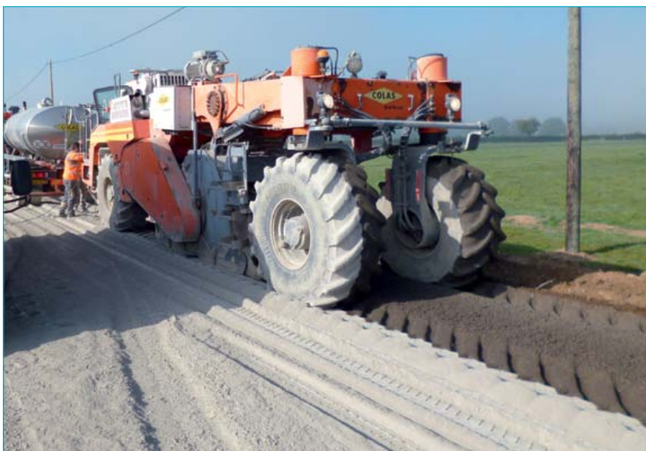
Etape importante : le malaxage. Au premier plan, le pulvimixeur malaxe et homogénéise le liant hydraulique avec les matériaux de l'ancienne chaussée.
