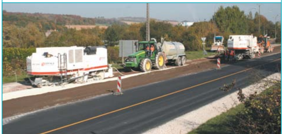
Sur ce chantier, deux ateliers de retraitement de chaussées travaillent en parallèle : à gauche, le nouvel ARC 1000 et à droite, l'ARC 700.
