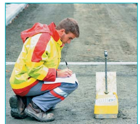
La mesure de densité sert à vérifier le bon compactage nécessaire à l'obtention de performances mécaniques élevées.
