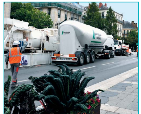
La livraison « juste à temps » du liant hydraulique est faite par camion-citerne de 25 tonnes en centre-ville, pour éviter toute rupture d'approvisionnement.
