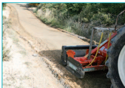
Le compactage termine la mise en œuvre des matériaux traités en place.
