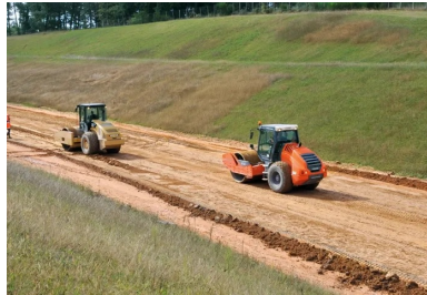
Neuf passes de cylindre vibrant ont été nécessaires pour obtenir la portance souhaitée (T2). Trafic attendu : 200 poids lourds par sens et par jour.
