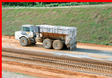
En quatre jours, 800 tonnes de liants Reliac Flex de Lafarge, provenant de l'usine d'Angoulême, ont été mises en œuvre.
