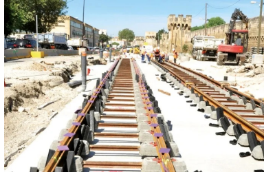
Les rails posés sur des traverses biblocs en béton, préfabriquées par Sateba. En gros plan, à droite, la partie sous patin de l'habillage des rails en mousse polyuréthane. Ces pièces (semelles élastiques) garnissent les rails avant le coulage du béton de calage. D'autres pièces viendront garnir les flancs du rail avant le coulage du béton de revêtement.
