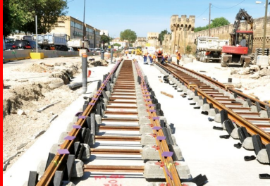
Les rails posés sur des traverses biblocs en béton, préfabriqués par Sateba. En gros plan, à droite, la partie sous patin de l'habillage des rails en mousse polyuréthane. Ces pièces (semelles élastiques) garnissent les rails avant le coulage du béton de calage. D'autres pièces viendront garnir les flancs du rail avant le coulage du béton de revêtement.
