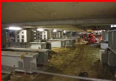
Les 119 poteaux existants sont repris en sous-œuvre afin de pouvoir construire la gare souterraine.
