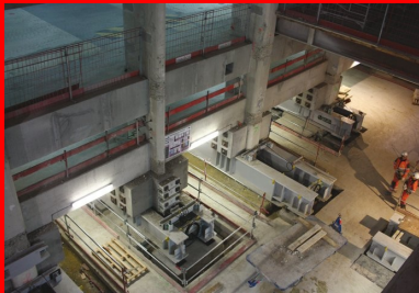
C'est par la « faille » que seront évacués les 150 000 m 3 de terre excavée lors du terrassement en taupe de la gare.
