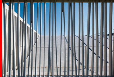
L'unité de post-dénitrification des eaux est desservie par une grande faille organisée entre les bassins de traitement et les locaux techniques intégrés sous une terrasse-jardin, une création originale de coques structurelles précontraintes et de nez résilles à base de BFUP se développe en couverture et en façade des bassins de traitement.
