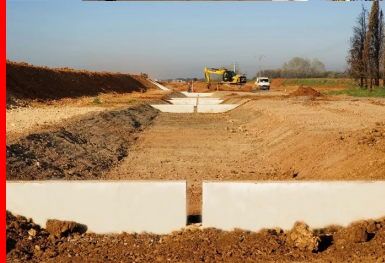
Caniveaux en crête et fossés en pied de remblai : des mesures pour protéger la plate-forme ferroviaire d'une éventuelle pollution.
