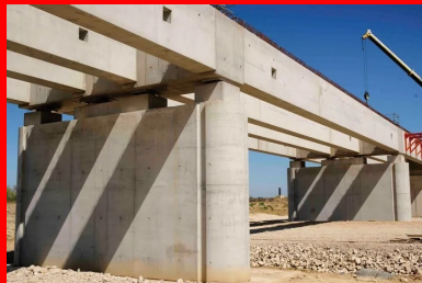
Les estacades sont constituées de poutres préfabriquées en béton armé reposant sur les piles.
