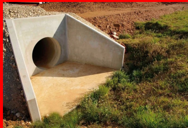
Buses et dalots facilitent l'écoulement de l'eau sous la plate-forme.
