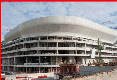
L'arena 92, et son couronnement de coques préfabriquées en béton de ciment blanc, réalisées par l'entreprise Joussein (angers).
