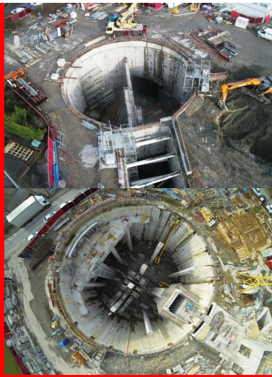
La station de pompage avec la bache de réception en partie centrale.
