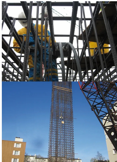
Chantier de la ligne b du métro de Rennes - intégration des tuyaux géothermiques : dans les piédroits, puis reliés à une pompe à chaleur
