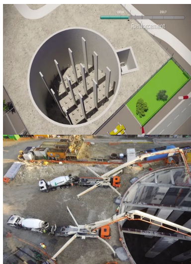
Avec 25 m de profondeur et 40 m de diamètre, la capacité du bassin est de 23 400 m 3 .
