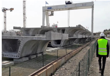
La maintenance des 973 voussoirs dans l'aire de stockage est effectuée par un portique mobile.
