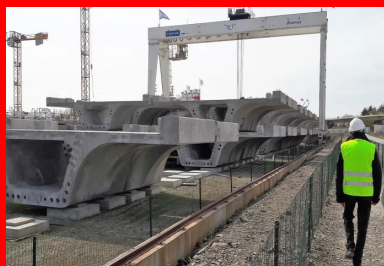
La maintenance des 973 voussoirs dans l'aire de stockage est effectuée par un portique mobile.
