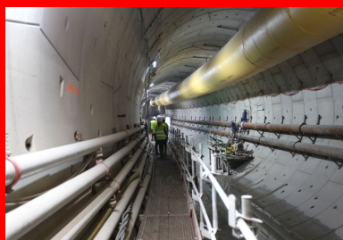
Intérieur du tunnel avec la conduite de marouflage pour l'exfiltration des déblais et la canalisation de boue bentonitique.
