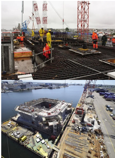
Travaux de mise en place des armatures sur le pont du flotteur.
