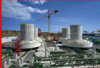
Les semelles de fondation cylindriques des embases de piles sont très massives : de 20 à 23 m de diamètre pour 4 m d'épaisseur.
