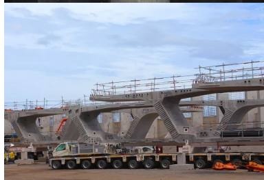
Stockage de voussoirs sur le site de pose. Le tablier est découpé en 1 386 voussoirs préfabriqués sur une aire dédiée de 9 ha à quelques kilomètres du chantier.
