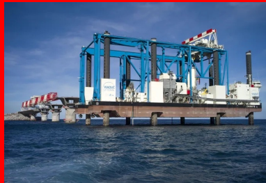
Zourite, la plate-forme automotrice, peut se stabiliser en se hissant sur ses 8 jambes d'acier. Les éléments de piles peuvent alors être installés dans des conditions équivalentes à celles de la terre ferme.
