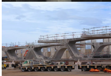
Stockage de voussoirs sur le site de pose. Le tablier est découpé en 1 386 voussoirs préfabriqués sur une aire dédiée de 9 ha à quelques kilomètres du chantier.
