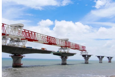
Appuyée sur les piles déjà en place, la poutre de lancement géante est capable d'assembler un fléau complet avant de se déplacer vers sa position suivante.
