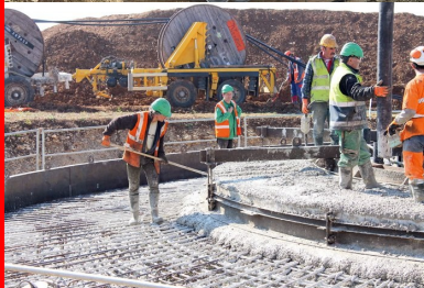
Pour réaliser les massifs de fondation des éoliennes, environ 100 kg d'armatures sont nécessaires par mètre cube de béton.
