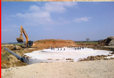
Un massif de fondation d'éolienne nécessite la mise en œuvre d'environ 400 m 3 de béton. Poids total : un millier de tonnes.
