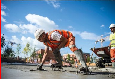
Après serrage, le béton frais a ensuite été finement taloché par des équipiers montés sur des chaussures à clous.
