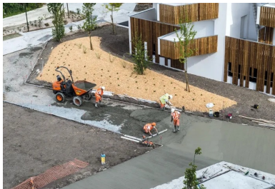
Acheminé sur le chantier par dumper, le béton a d'abord été tiré à la règle.
