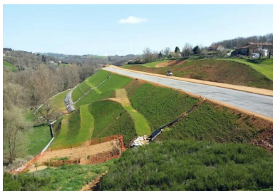
Le nouveau tronçon de la RN82 doit servir d'itinéraire alternatif au sud de Roanne (Loire). Une partie du traitement de la couche de forme a été réalisée entre mars et juin de cette année, à raison de 250 mètres linéaires par jour.
