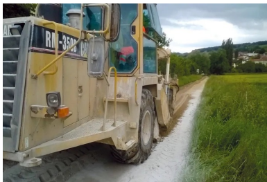
Étape essentielle pour assurer l'homogénéité du matériau : le malaxage, réalisé sur 35 cm de profondeur et sur une largeur de 3,50 à 4 m.
